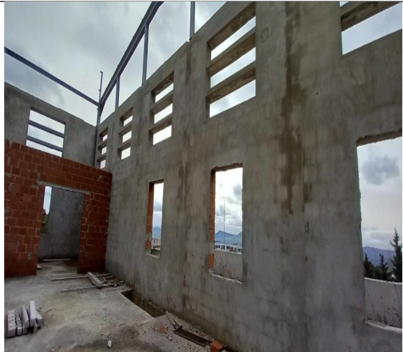
أشغال متوقفة من داخل مبنى الورشات
