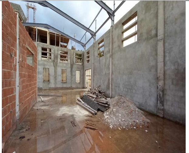
أشغال متوقفة من داخل مبنى الورشات.
