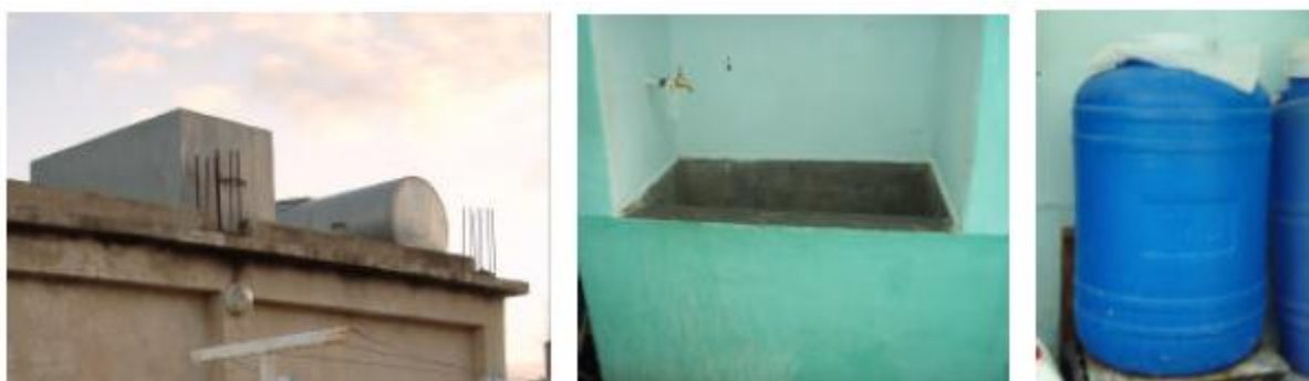
Photo 1 : Exemples d'équipements de stockage (fixes ou transportables)
