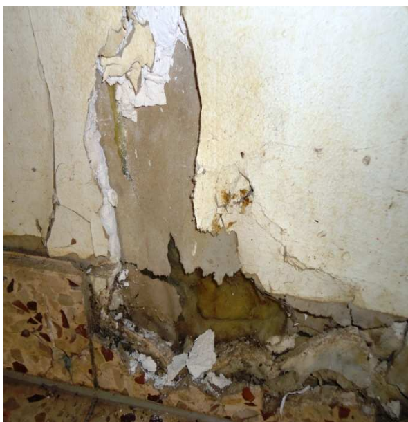
Figure 5: Dégradation des éléments de séparation en plaques de carton-plâtre
