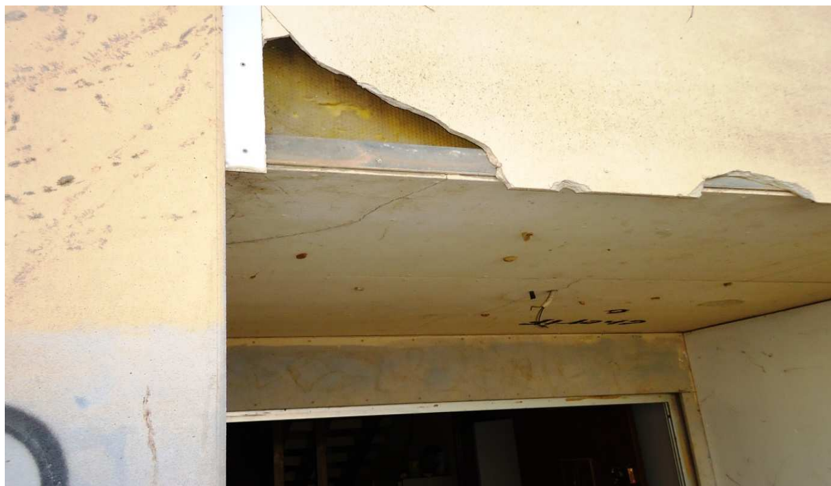
Figure 6: Détérioration des éléments de plaques en amiante.
